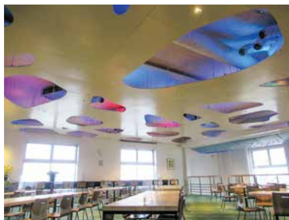
社員食堂（ベルテクネ製のシーリング）
